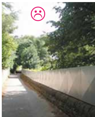
Barrière infranchissable pour la faune
